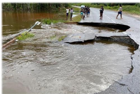
Dégâts sur la RN1, crédit : France info
